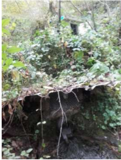
Illustration 14 : Vue du trop-plein et du captage de « Caou Deque les Plagnous » en arrière-plan (Source : S. Hillairet, 2018, Avis de l'hydrogéologue agréé en matière d'hygiène publique)
